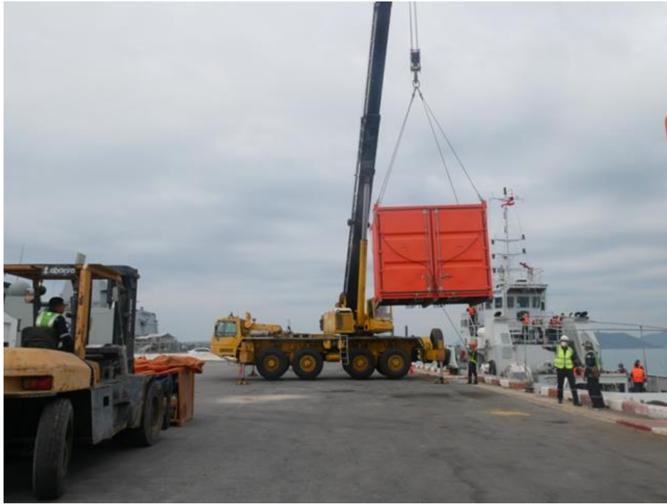
รูปภาพที่ ๓ ยกตู้อุปกรณ์จัดคราบน้ำมันลงเรือลากจูง
